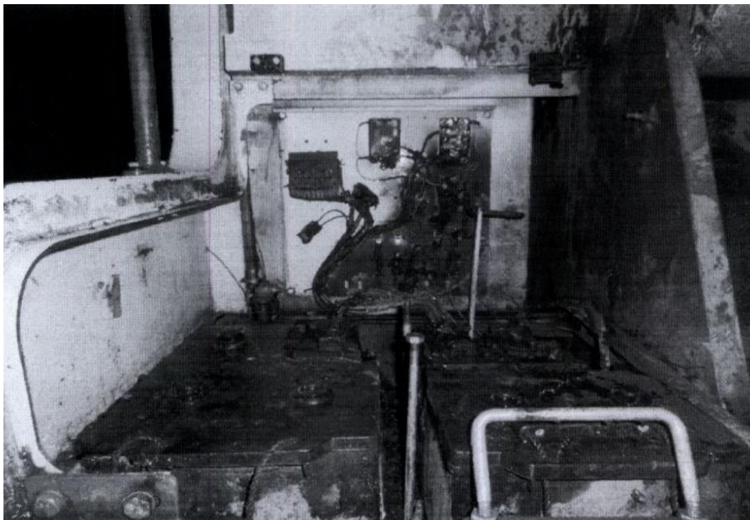
Рис. 2. Фото задней стенки аккумуляторного отсека (подготовлено дознавателем Я.)
